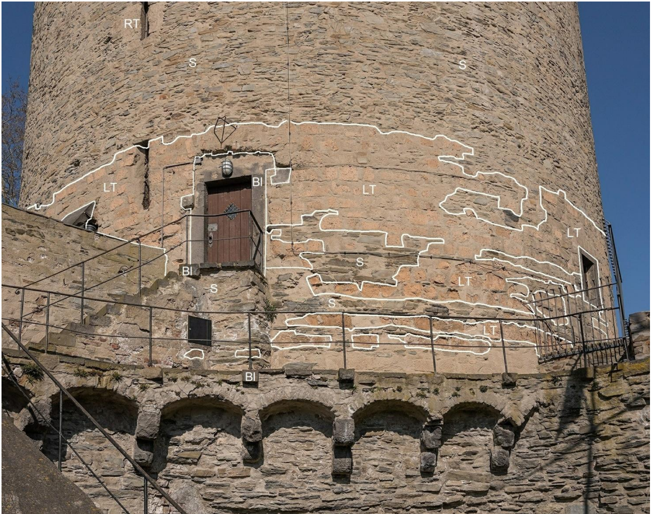
Abb. 33 Andernach, Runder Turm, vor 1440-1453 Detailkartierung des unteren Turmschaftes Bruchsteinmauerwerk mit schiefrigen Sandsteinen / ugs. „Grauwacke“ (S), Laacher Tuff (LT), Basaltlava (BI) und Römertuff (RT) (Foto: HG)
